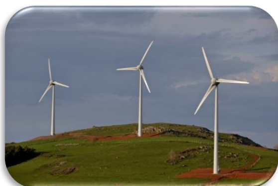
Parc éolien de Saulzet de 14,4 MW situé en Auvergne et mis en service en 2009
